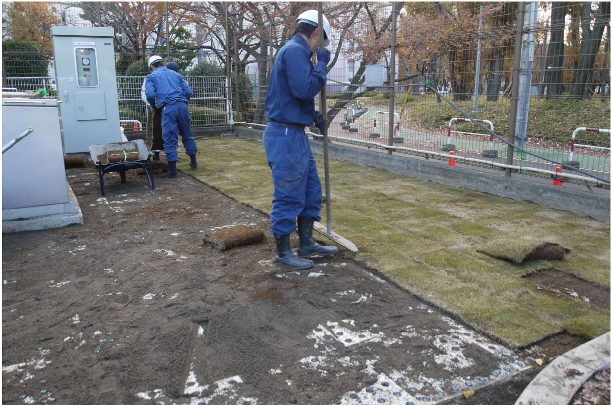
東久留米市 滝山浄水場
